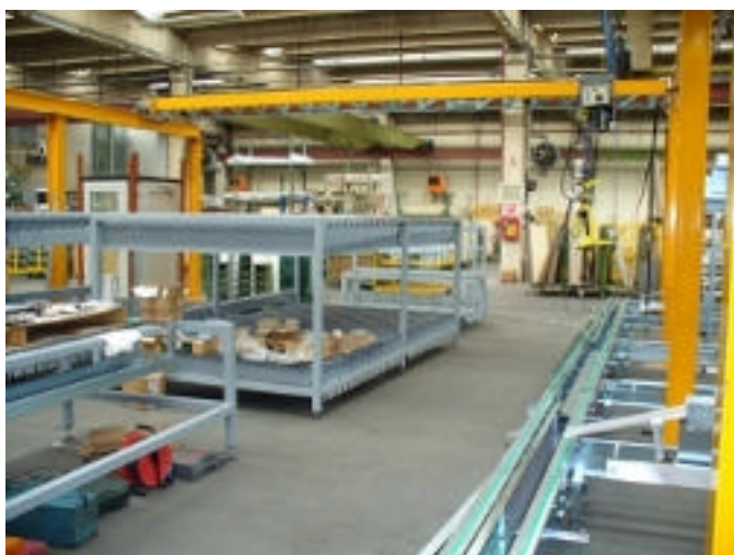
Vista frontale del carro ponte
